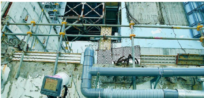
壁が崩壊し鉄筋がむき出しになった3号機原子炉建屋。線量計は毎時227マイクロシーベルトを示しています＝2月23日（代表撮影）
